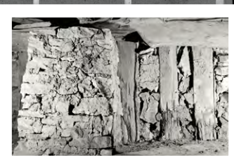
▲ DÉTAIL DU CELLIER DE LA MAISON AMOUREUX MONTRANT LES POTEAUX VERTICAUX EN CHÊNE QUI S'ENFONCENT DANS LE SOL, PHOTOGRAPHIÉ EN 1986 Library of Congress, Prints and Photographs Division, HABS MO,97-SAIGEN,13-16
