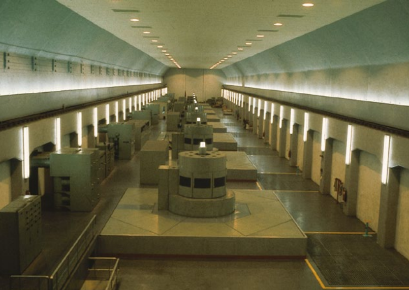
CENTRALE SOUTERRAINE DE BERSIMIS 1, INAUGURÉE EN 1956. Centre d'archives Hydro-Québec, série H1-701-207.
